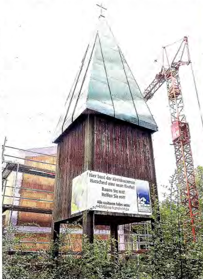
Der Rohbau in Nümbrecht-Harscheid steht bereits. Noch in diesem Herbst soll Richtfest gefeiert werden. Fotos: Pluwatsch
